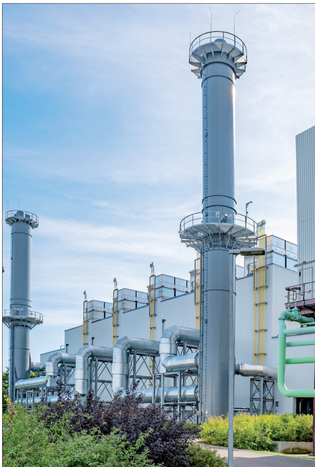
Das hochmoderne Frankfurter Heizkraftwerk.
